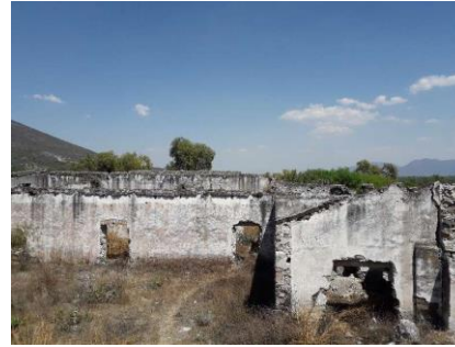
Imagen 2. Daños y deterioros encontrados en la exhacienda. Fuente: Elaboración propia.
