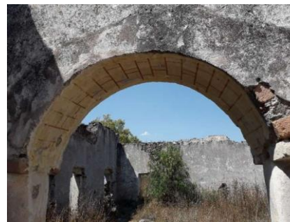
Imagen 3. Daños y deterioros encontrados en la exhacienda. Fuente: Elaboración propia.
