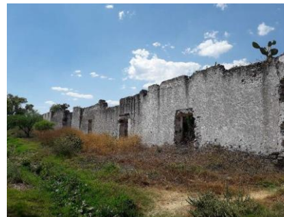
Imagen 4. Daños y deterioros encontrados en la exhacienda. Fuente: Elaboración propia.
