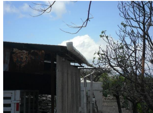
Imagen 6. Sistema de captación de agua pluvial. Fuente: Elaboración propia
