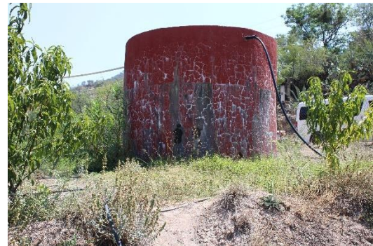
Imagen 7. Tanque de almacenamiento de agua prefabricado en avanzado estado de deterioro. Fuente: Elaboración propia.
